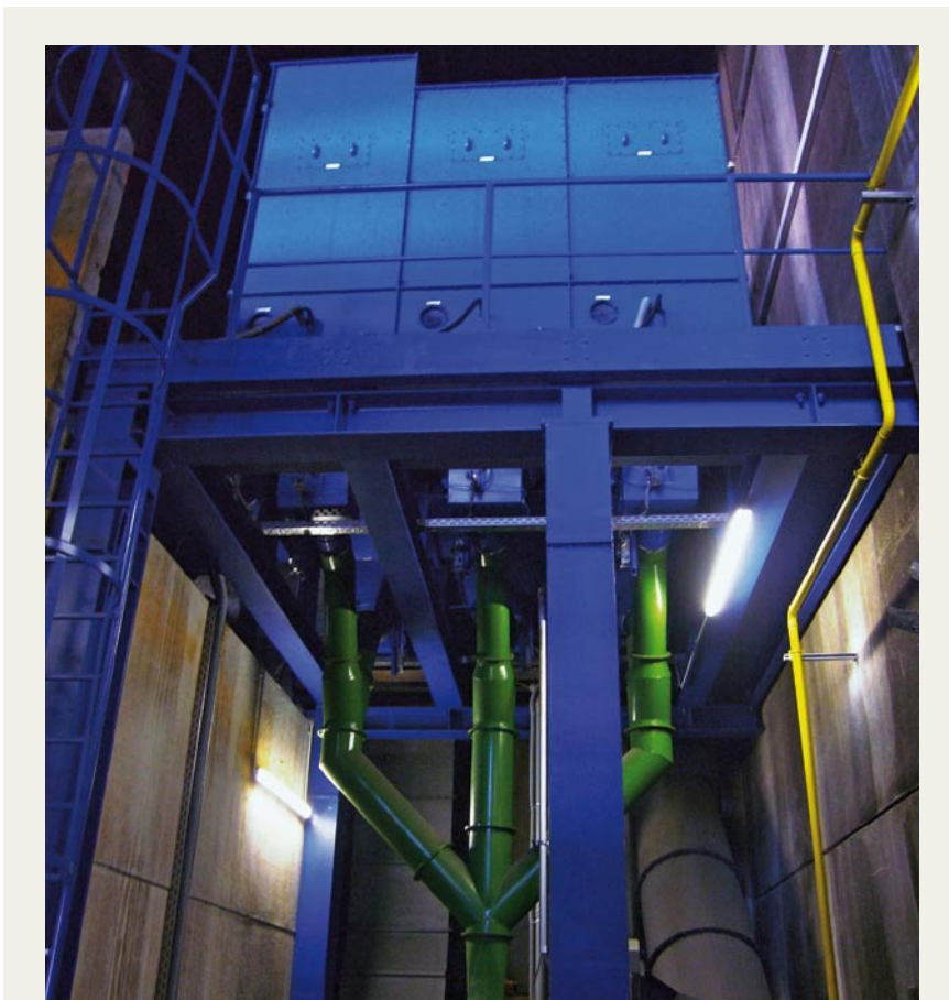
Die Sinterlamellenfilter der Absaugung erzielen eine Reststaubkonzentration unter 1mg/m 3
