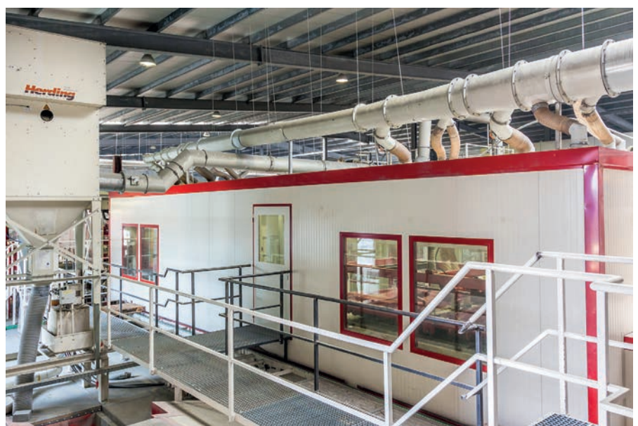
Herding Flex als zentrale Filteranlage im Einsatz bei der Firma Godelmann
