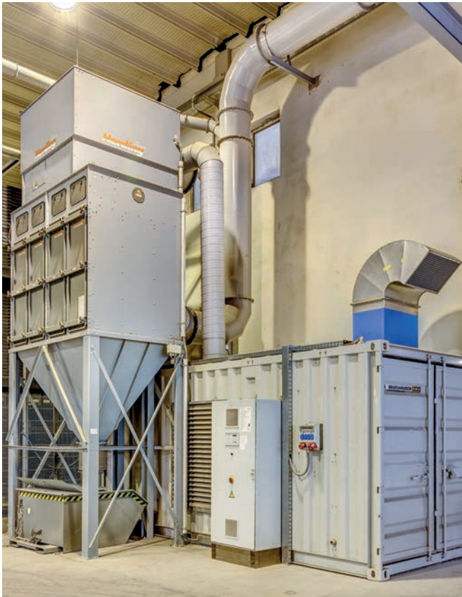
Odpylanie kabinowe z odprowadzeniem powietrza do komory sprężania.
